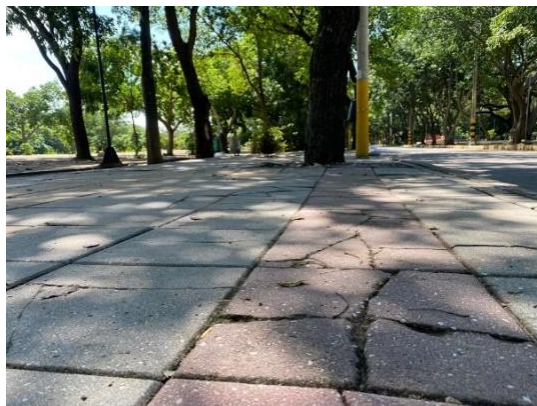
Imagen 1: Andenes existentes en mal estado
