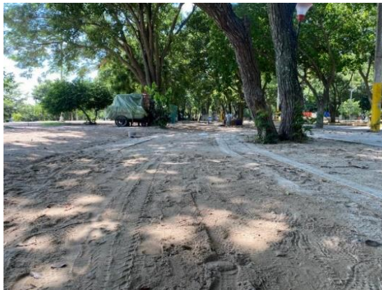
Imagen 2: Ciclorruta existentes en mal estado
