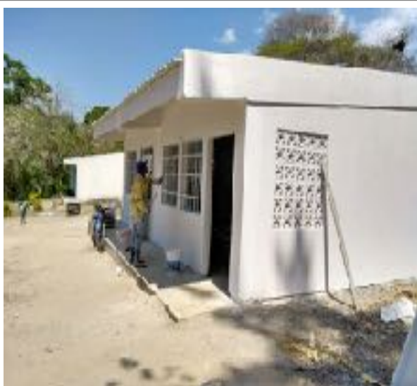
Foto N° 27 Vista General, Detalle de Pintura en Fachadas Frontal y Lateral Derecha
