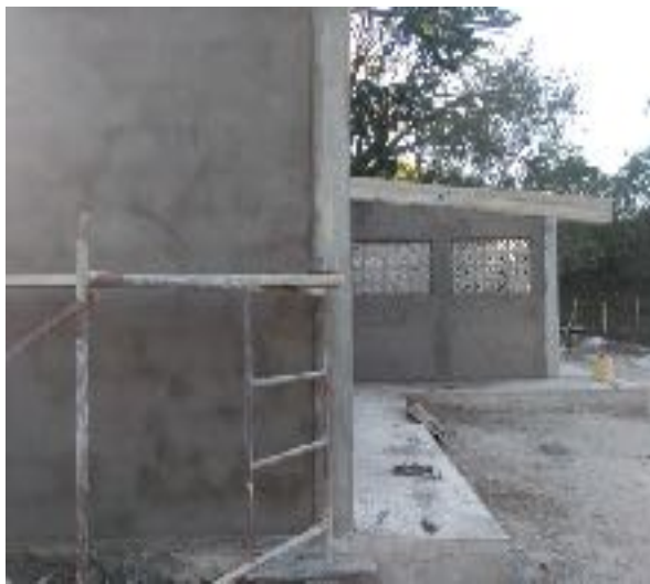
Foto N° 9 Vista General, Pañete sobre fachada Posterior y Lateral Derecha
