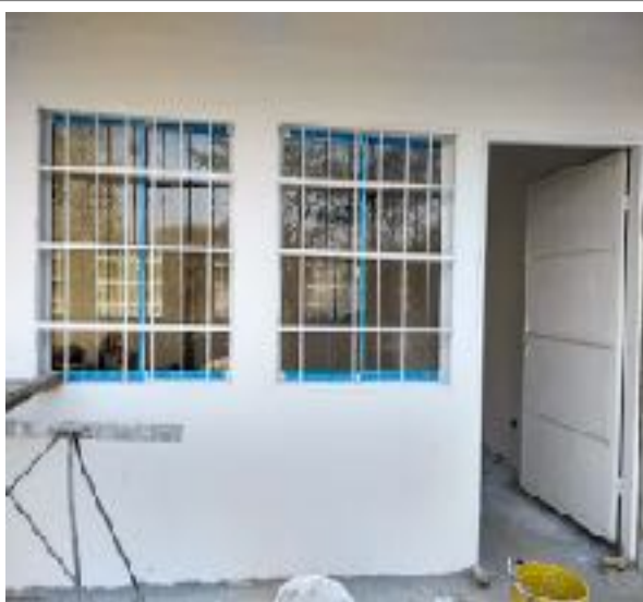
Foto N° 23 Vista General, Colocación de Ventana, Protectores y Puerta Principal del salón de clases.
