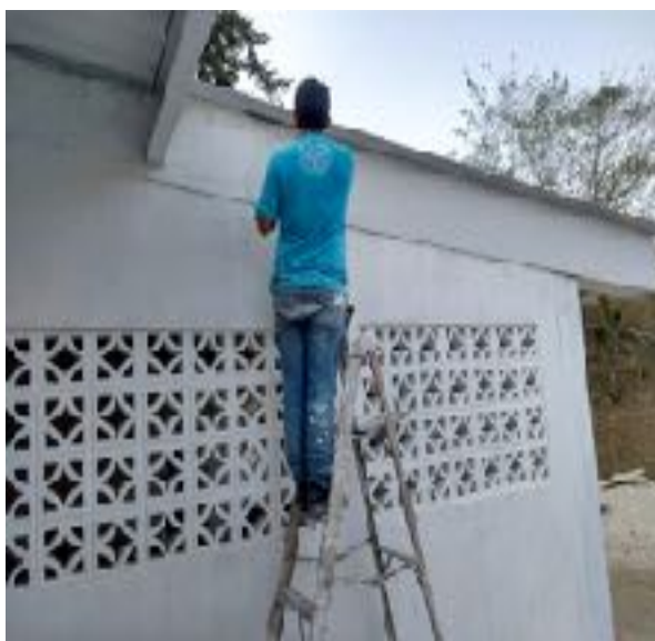
Foto N° 24. Vista General, Detalle de Viga aérea posterior con estuco y pintura tipo #1
