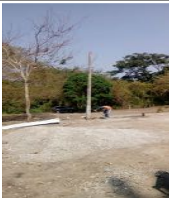
Foto N° 34 Vista General, Poste de Concreto de 8MTS 510 Kg
