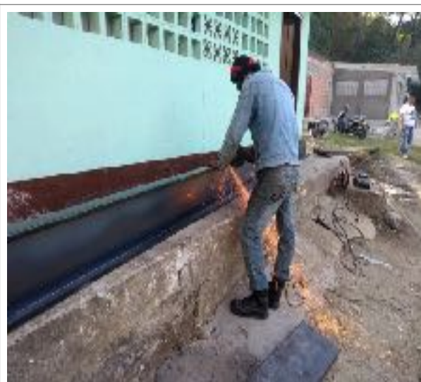
Foto N° 11 Vista General, Inicio de Actividades de Colocación de Estructura de Cubierta, Según diseño
